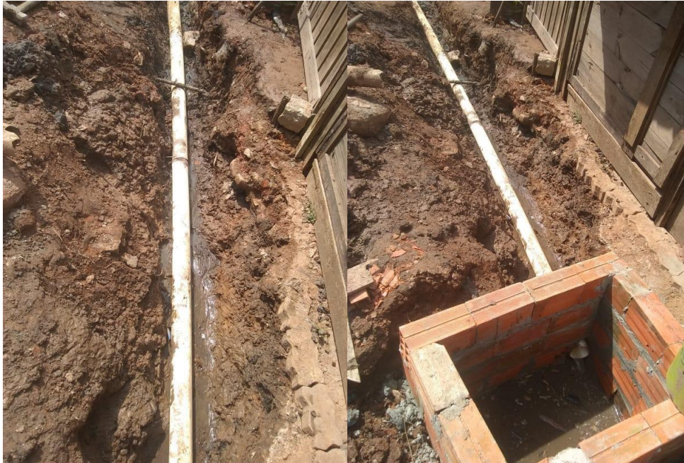
Figura 4: A. Encanação na rua central. B. Com caixa de escoamento.
